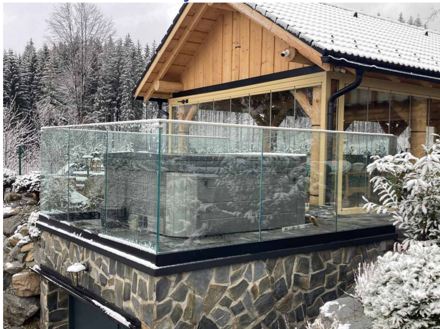
Sklenené zábradlie View Crystal
